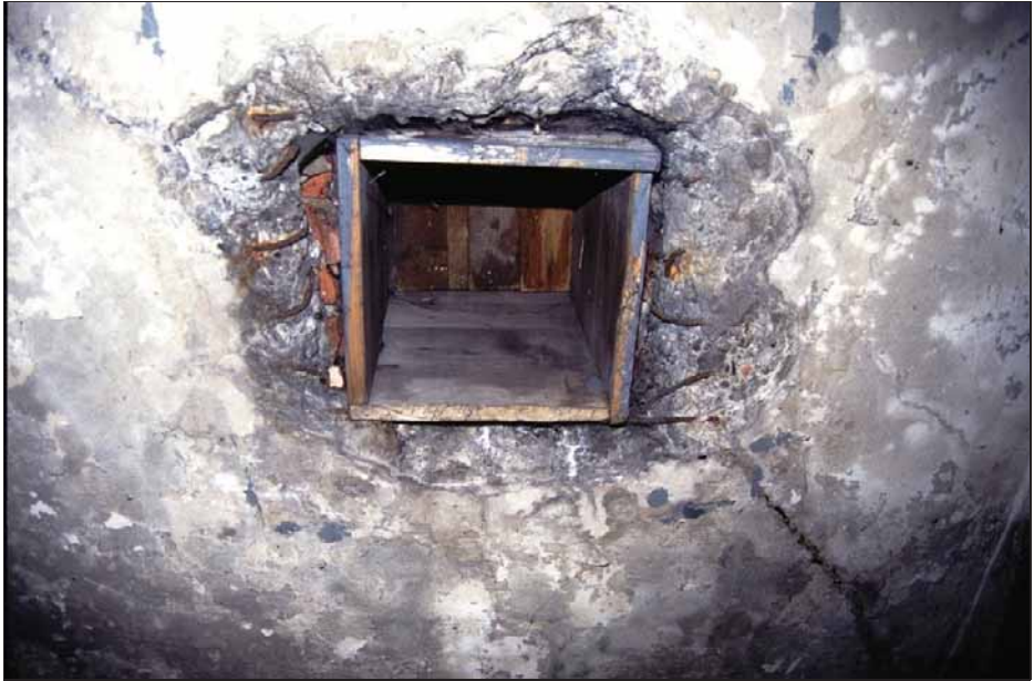
Abbildung 50: Eines der vier Löcher im Dach der sogenannten "Gaskammer" von Krematorium I, auf primitive Weise 1947 von den polnischen Museumsbehörden geschaffen.
