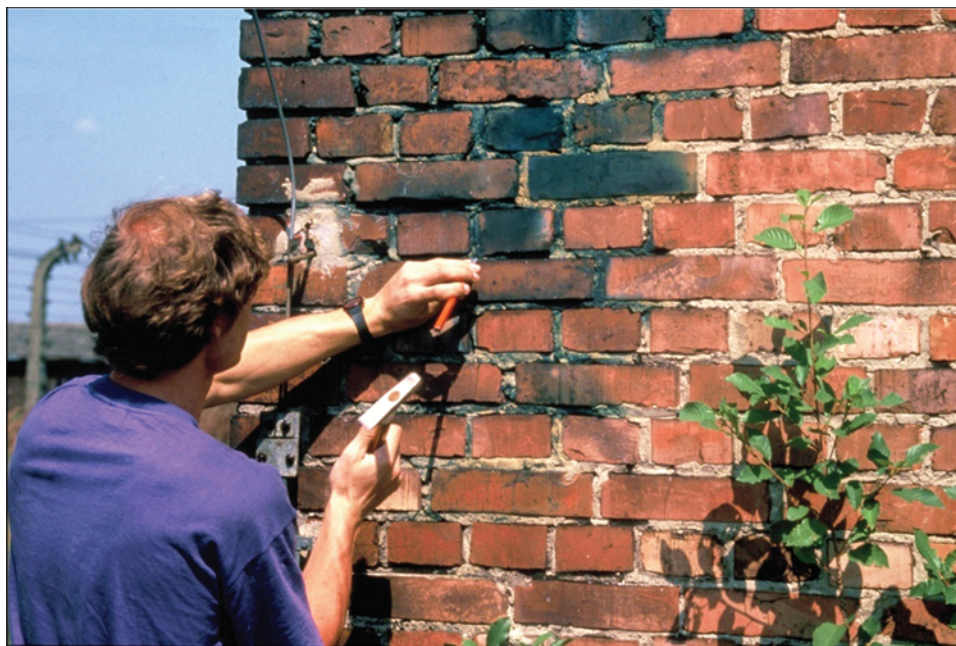
Abbildung 142: Die südliche Außenwand des Blausäure-Entwesungsflügels des Bauwerks 5a im August 1991 mit dem Autor. Geringe Mengen an Cyanid, die durch die Mauer diffundierten, färben die Wand bis heute stellenweise blau. 50 Jahre widrigste Witterungsverhältnisse taten dem keinen Abbruch.
