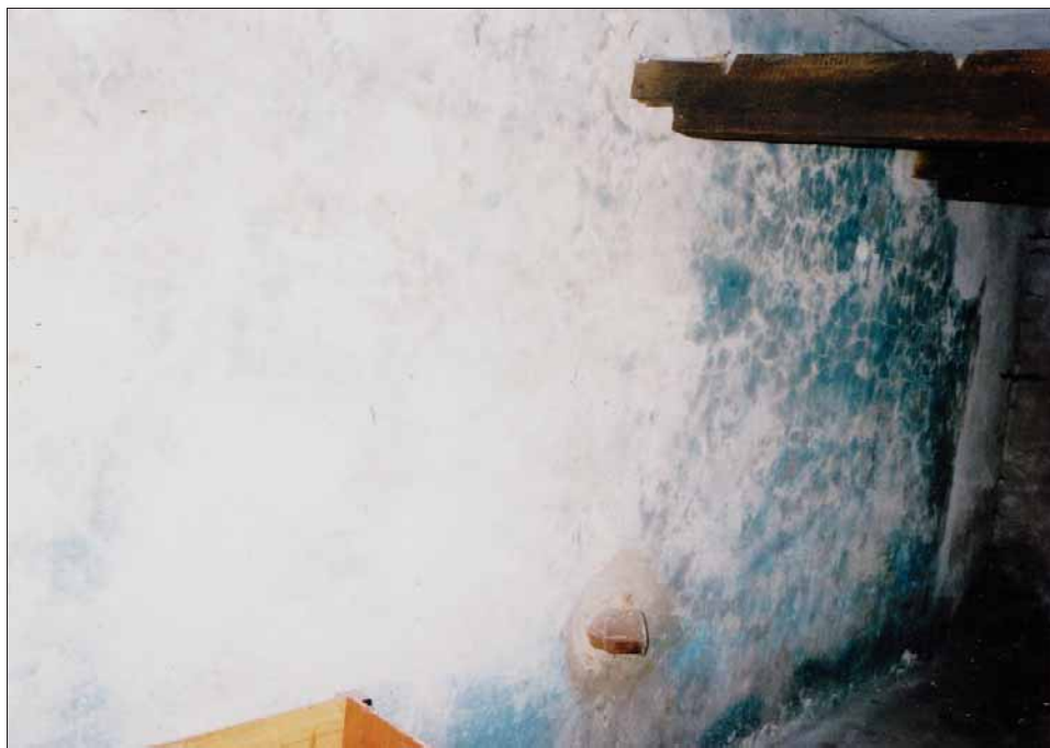
Abbildung 155: Entwesungstrakt des Bauwerks 5a, östliche Innenwand, nicht ganz so intensiv verfärbt wie die Außenwände (Raum 1 in Abbildung 41, von Norden gesehen). (© C. Mattogno 1992)
