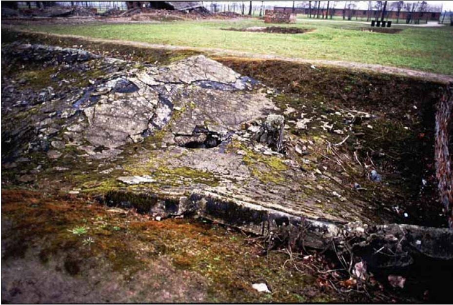
Abbildung 64: Leichenkeller 1 von Krematorium II in Birkenau, kollabiertes Dach, einigermaßen erhaltener, noch zugänglicher hinterer Teil. Mitte: Die letzte der sieben Betonsäulen ragt aus dem Dach hervor. Etwa einen Meter links davon: ein durch das Dach gemeißeltes Loch, um Zugang zum Bereich darunter zu erhalten (siehe Abb. 82, S. 138). (Februar 1997)
