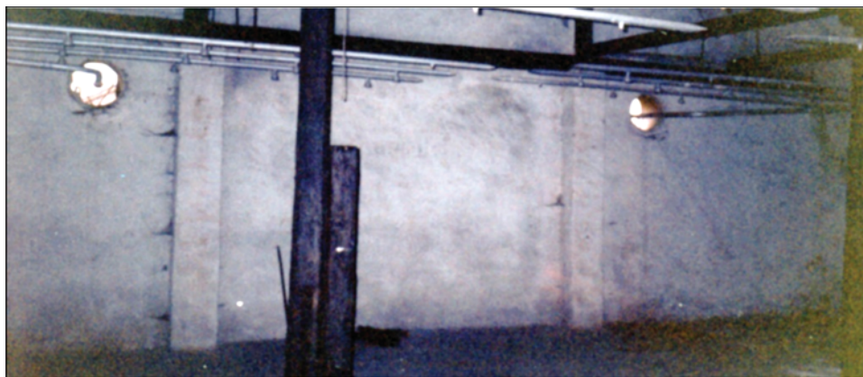
Abbildung 147: Innenaufnahme der Ostwand des Entwesungstrakts von Bauwerk 5b mit nur geringer Verfärbung des kalkreichen, eisenarmen Verputzes.
