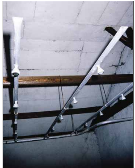
Abbildung 43: Wasserrohrsystem mit Duschköpfen im Entwesungstrakt des Bauwerks 5b. Diese Wasserrohre haben keinerlei Anschluss, sie enden in den Entlüftungsöffnungen. Siehe Abbildung 42.
