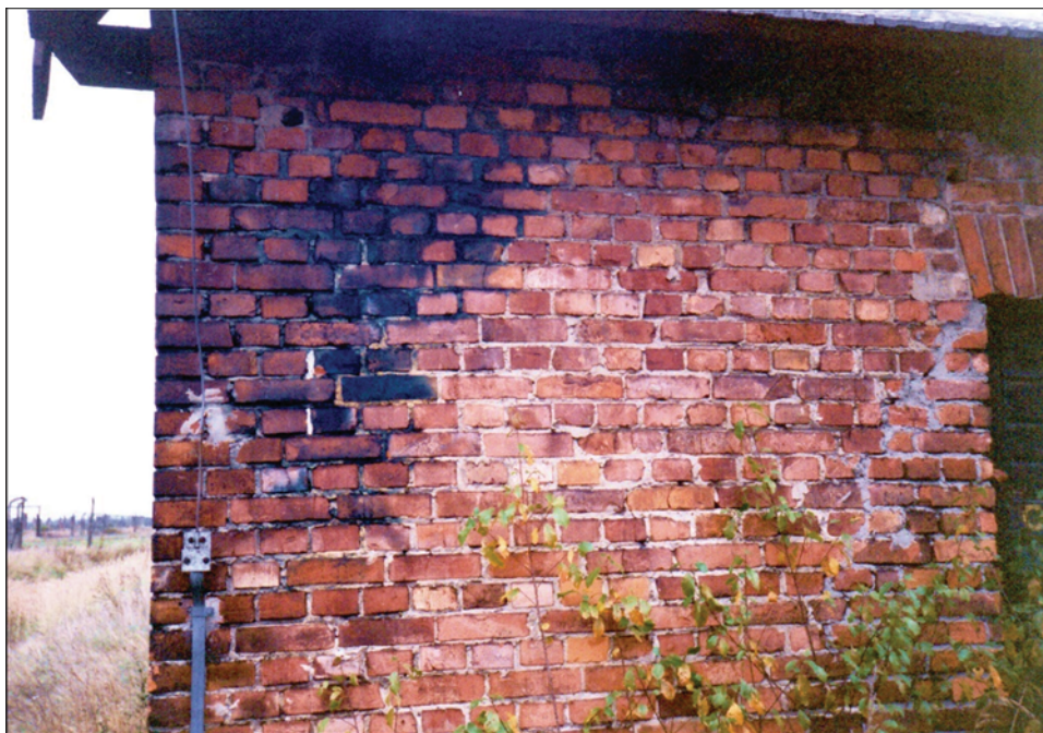
Abbildung 166: Entwesungstrakt des Bauwerks 5a, Südwand mit leichter Verfärbung an der Ecke. (© C. Mattogno 1991)
