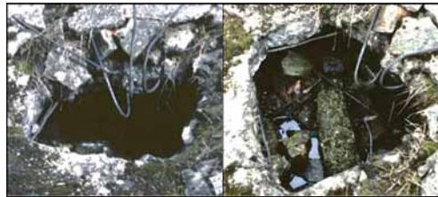
Abbildungen 85 & 86: Das gleiche Loch wie zuvor, Foto vom Feb. 1997 von Dr. Fredrick Töben. Links: vor seinem Versuch, die Bewehrungseisen zurückzubiegen. Rechts: nach diesem Versuch, mit beiden Eisenstäben abgebrochen am Boden des Lochs liegend.
