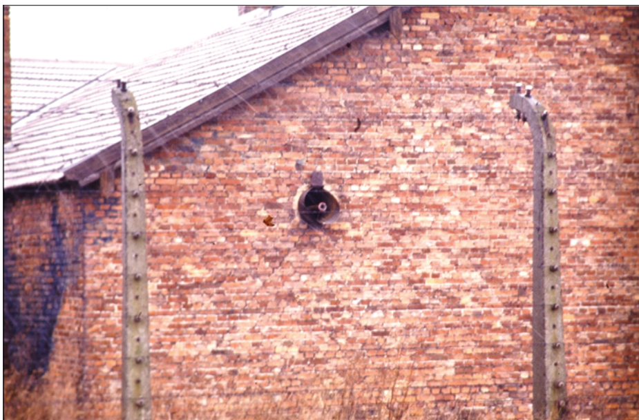
Abbildung 42: Entlüftungsöffnungen des Entwesungstraktes des Bauwerks 5b, heute ohne Apparaturen. Man erkennt darin die Enden der Wasserleitungen, siehe auch Abbildung 43 .
