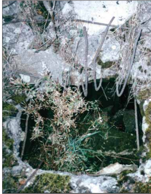
Abbildung 84: Loch in der Decke des Leichenkellers 1 (“Gaskammer”) vom Krematorium II. Es ist deutlich sichtbar, dass es nicht von den Bewehrungseisen des Stahlbetons befreit wurde. Diese wurden einfach nach hinten umgebogen. © Dez. 1991 Carlo Mattogno
